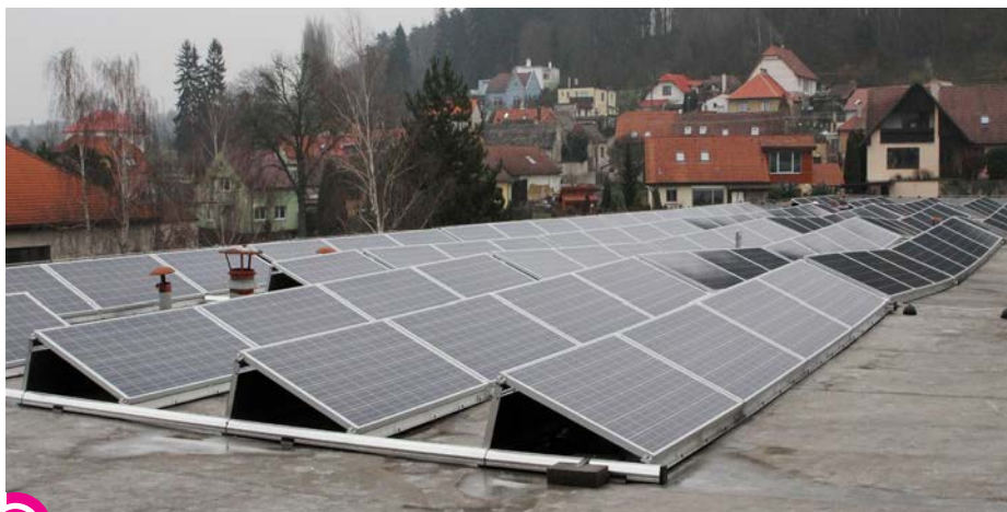
Panely fotovoltaické elektrárny
