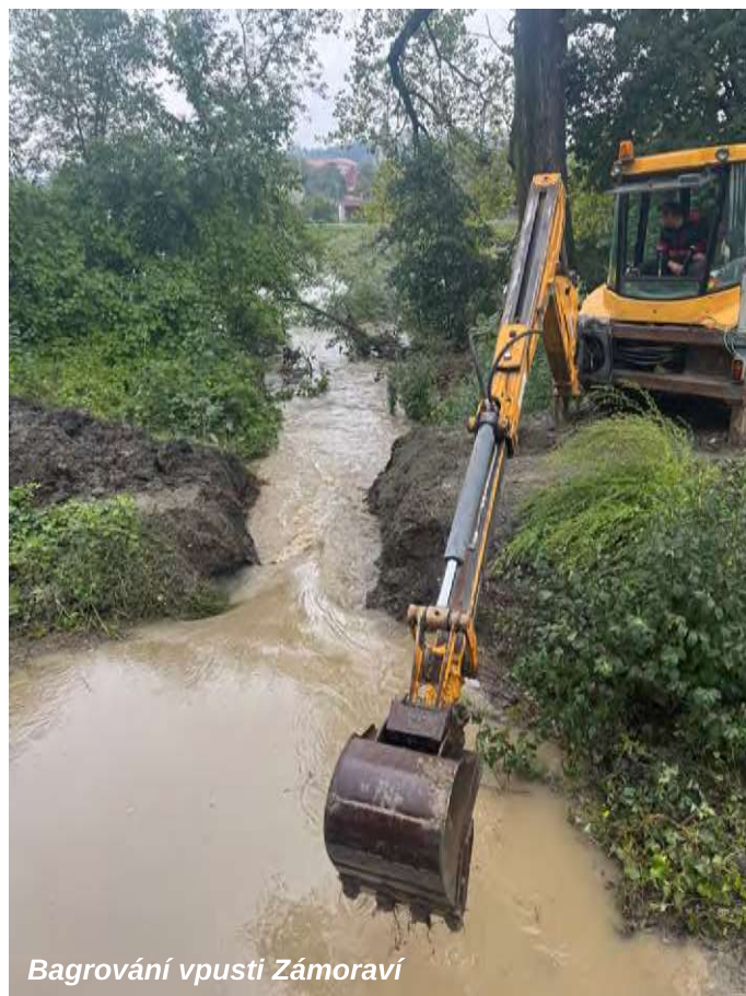
Čerpání vodní laguny v obci Bílovice, která vznikla po vylití místního potoka
